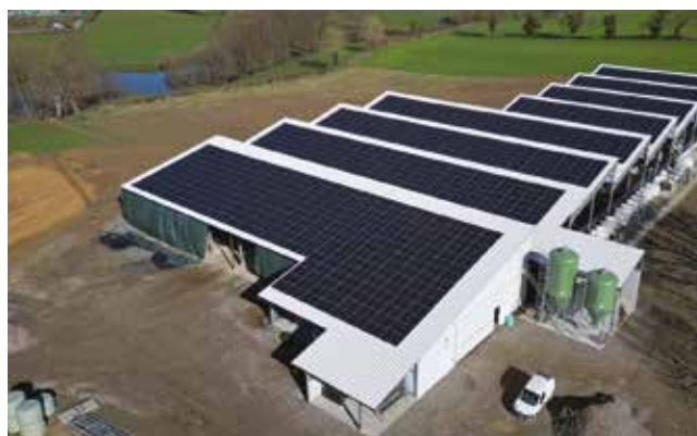
Toiture solaire sur bâtiment agricole – Moncoutant sur sevre (79) – 497 kWc
